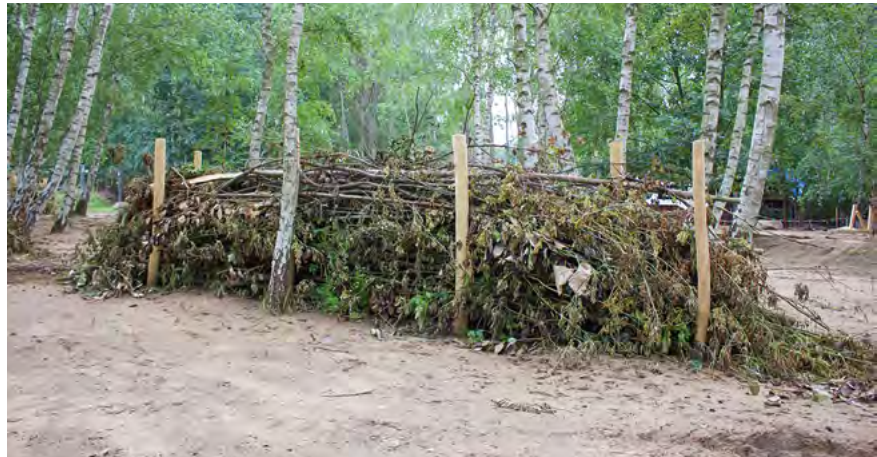
Einbau eines Lagers für lose Materialien (Stöcke, Schnittgut) im NER „Wilde Welt“ an der Moorwiese, Berlin. Im Rahmen der Planung sollten grundsätzlich ausreichend große Lager für Spielmaterial vorgesehen werden. (Claudia Friede)
