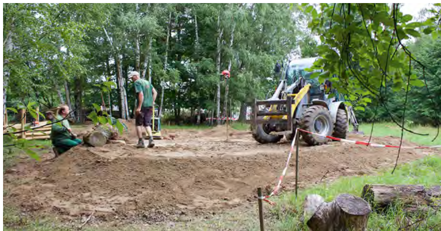
Einbau einer Sandfläche mit einer Einfassung aus Baumstämmen im NER „Wilde Welt“ an der Moorwiese, Berlin (Claudia Friede)
